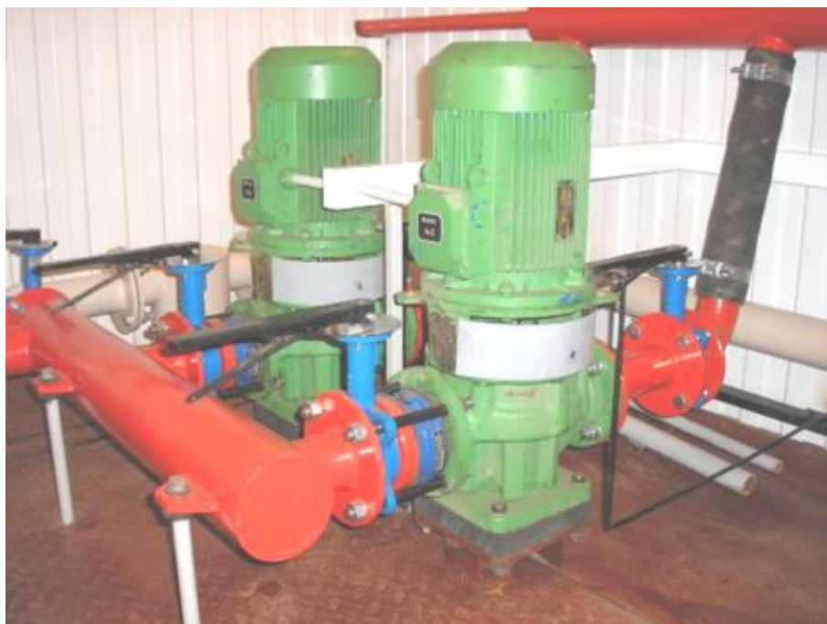
Рис. № 4 Блок электронасосов.
