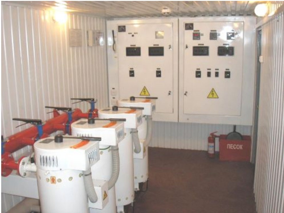
Рис. № 2 Электрокотельная ЭК-400БК, ЭК-400БКм. Вид изнутри.
